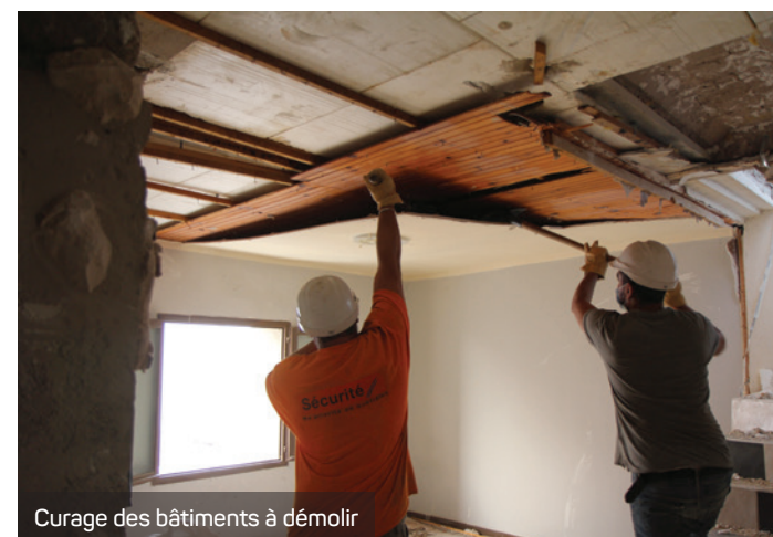
Valorisation des matériaux recyclables
